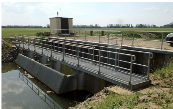
Stauanlage mit Rechen
